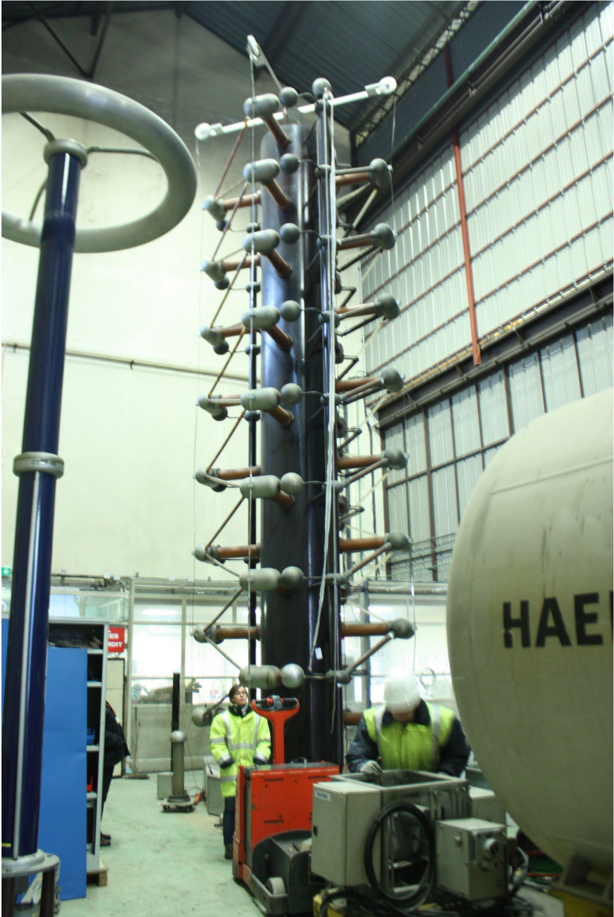
Le générateur de chocs de GE Power, avant son démantèlement en janvier 2018. Photo ACONIT / GE Power.
