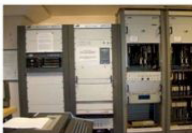
Les armoires de commande
